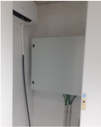
Figura 62. Armario de comunicaciones Osmosis CCM
