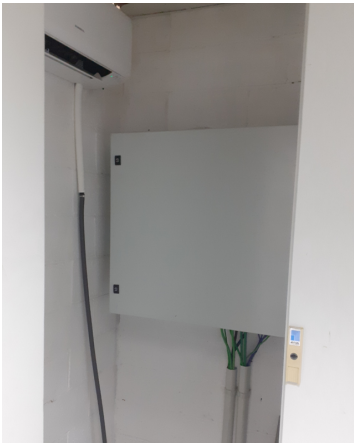
Figura 62. Armario de comunicaciones Osmosis CCM
