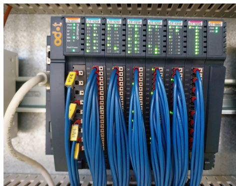
Figura 10. Señales remotas QE5
