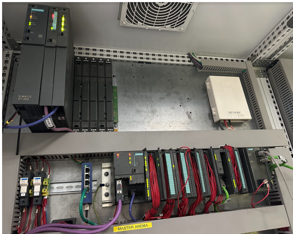
Figura 17. Cuadro de control del CCM de Osmosis
