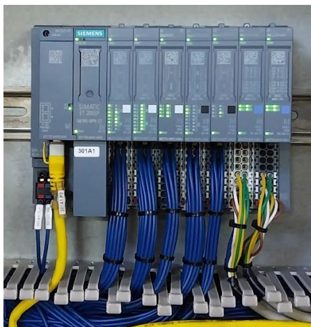
Figura 7. Señales remotas QE6
