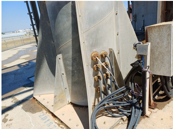
Detalle cuadro eléctrico y prensaestopa
