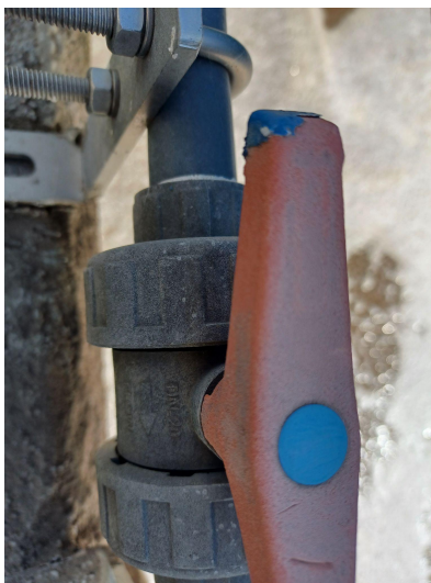
Foto 3:tubos de purga
