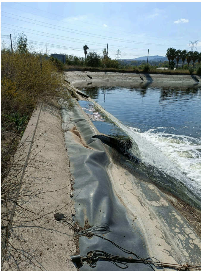
Entrada aigua i sobreexidor
