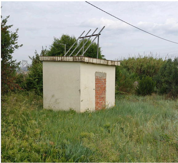
Caseta de control tapiada
