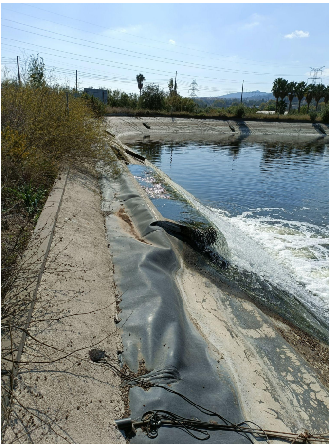
Entrada aigua i sobreexidor
