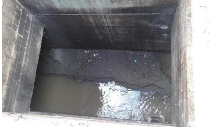
Foto 7: Ejemplo de desarenador en vía pública
