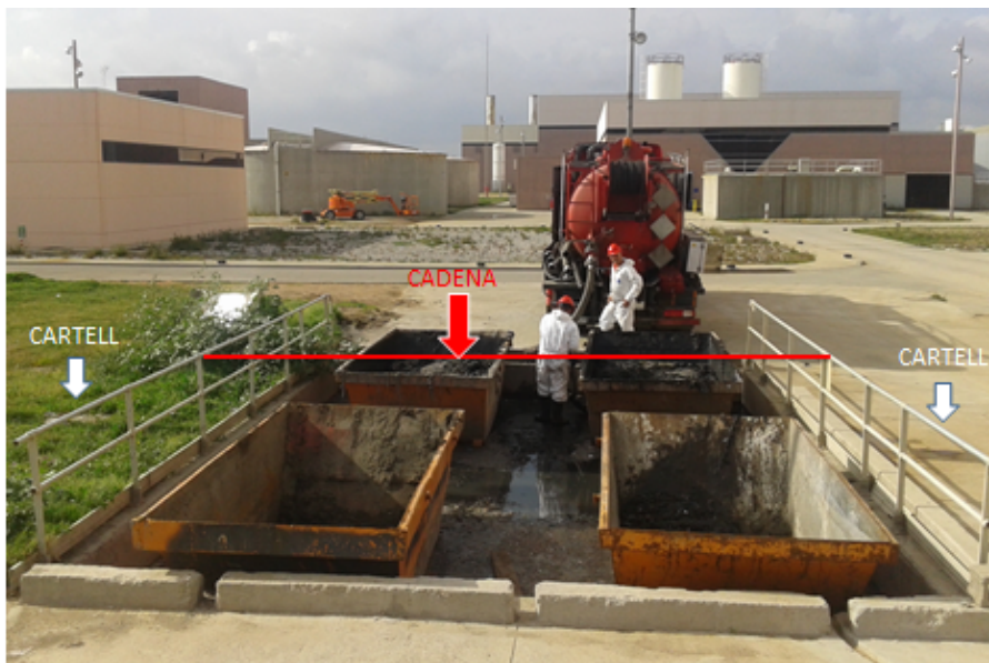
Foto 1: Zona de contenedores de descarga de arenas de Colector en EDAR Prat
