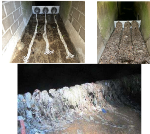
Foto 6: Ejemplos de elementos de retención en la red de colectores
