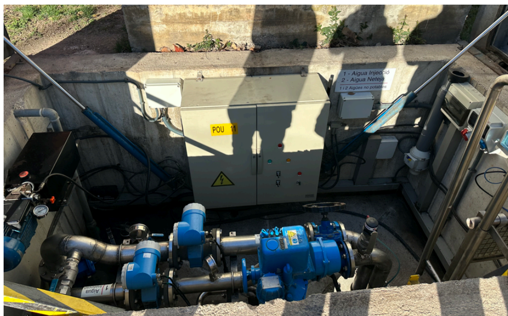
Figura 58. Armario Control Pozo Fase 2 - Subterráneo
