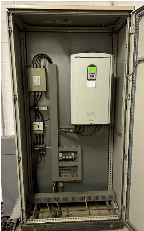
Figura 19. Pou 1 - Cuadrante variador SD-500
