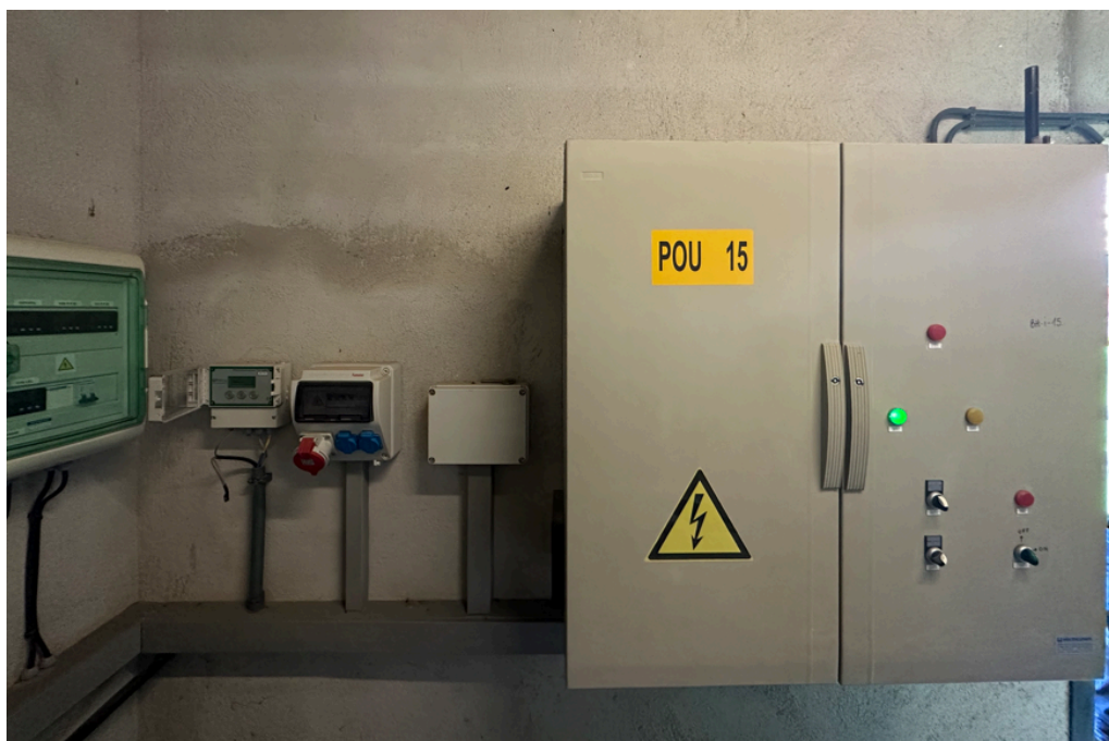
Figura 57. Armario Control Pozos Fase 2 - Caseta
