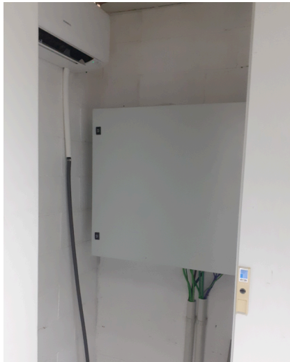
Figura 62. Armario de comunicaciones Osmosis CCM
