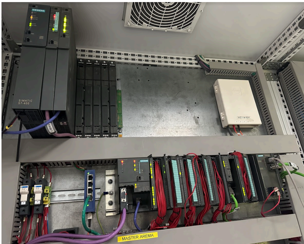
Figura 10. Cuadro de control del CCM de Osmosis
