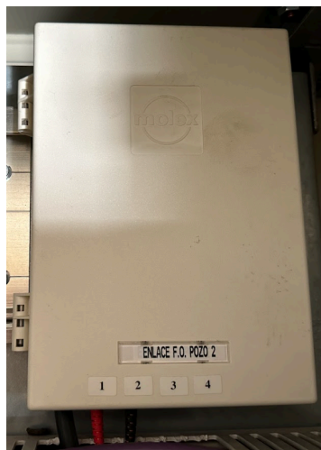
Figura 7. Caja Patch Panel de enlace F.O. Pozo 2 (ampliado), ubicado en el Cuadro de control del pozo 1.
