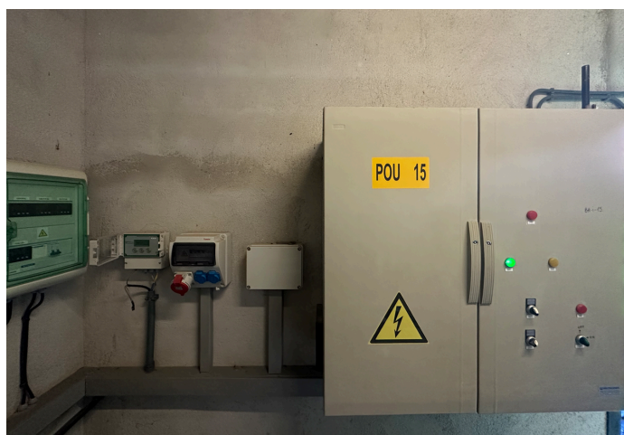
Figura 33. Pozo 15 - Cuadro de control (exterior)
