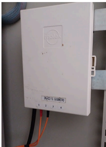
Figura 6. Caja Patch Panel de enlace F.O. Gasómetro (ampliado), ubicado en el Cuadro de control del pozo 1
