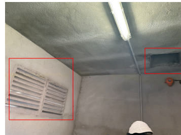
Figura 54. Salida de la antena, pozo 15
