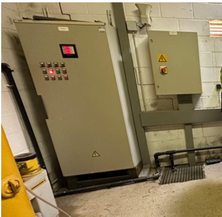
Figura 55. Armario de control Pozo 1
