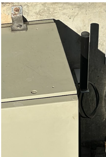
Figura 14. Antena del MD-741 ubicada fuera del armario de Control
