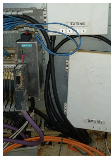
Figura 8. Cajas Patch Panel de enlace F.O. Pozo 1 y Enlace F.O Pozo 3, ubicadas en los Cuadros de control del Pozo 2, con convertor de F.O a Profibus DP.
