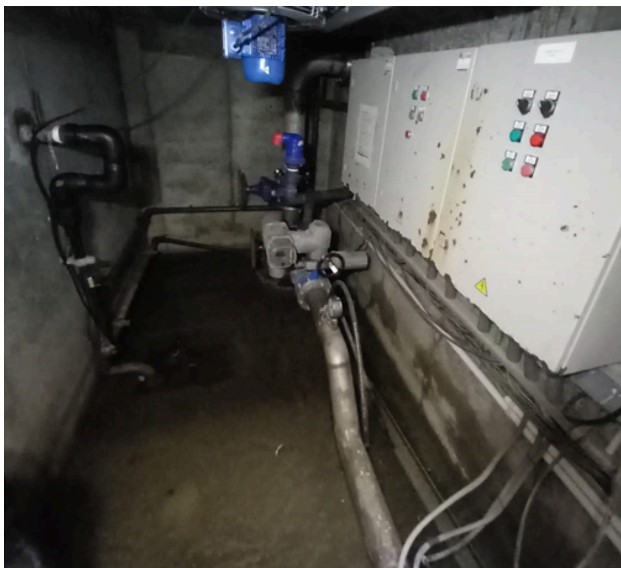
Figura 56. Armario Control Pozo 2 y 3
