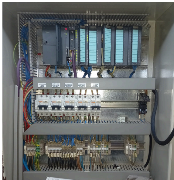
Figura 24. Pozo 2 - Cuadro de Control (I) con CPU 315-2 DP
