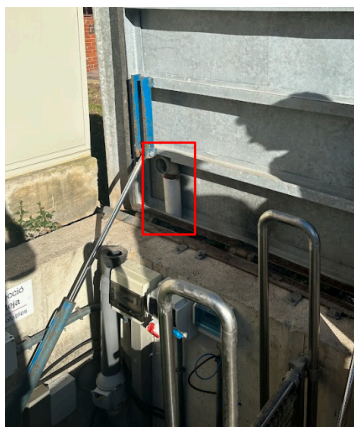
Figura 53. Salida de la antena, pozo 11
