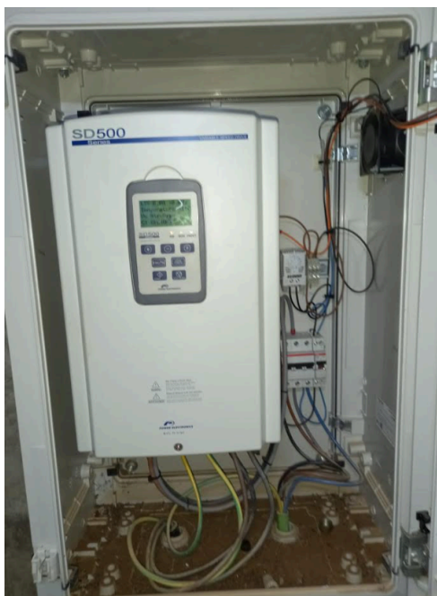
Figura 27. Pou 2 - Cuadro Variador SD-500
