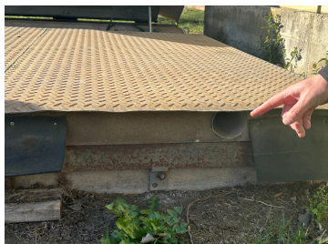
Figura 52. Salida de la antena, pozo 11
