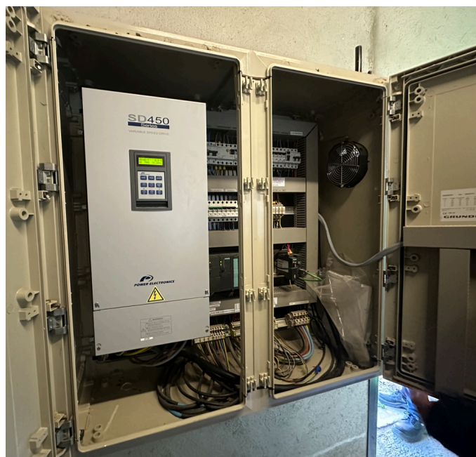
Figura 34. Pozo 15 - Cuadro de control (interior)
