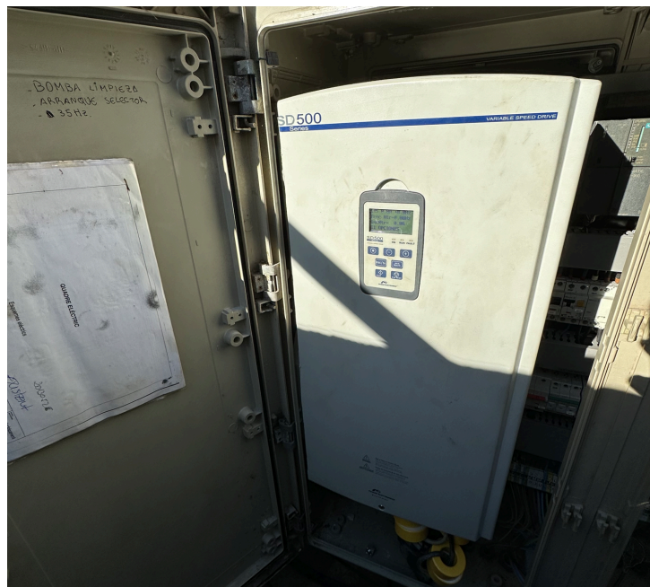
Figura 32. Pozo 11 - Variador SD500
