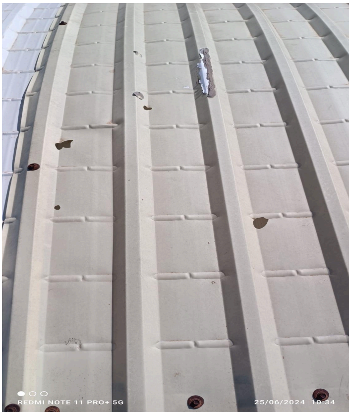
Foto 2: lluernaris en mal estat
