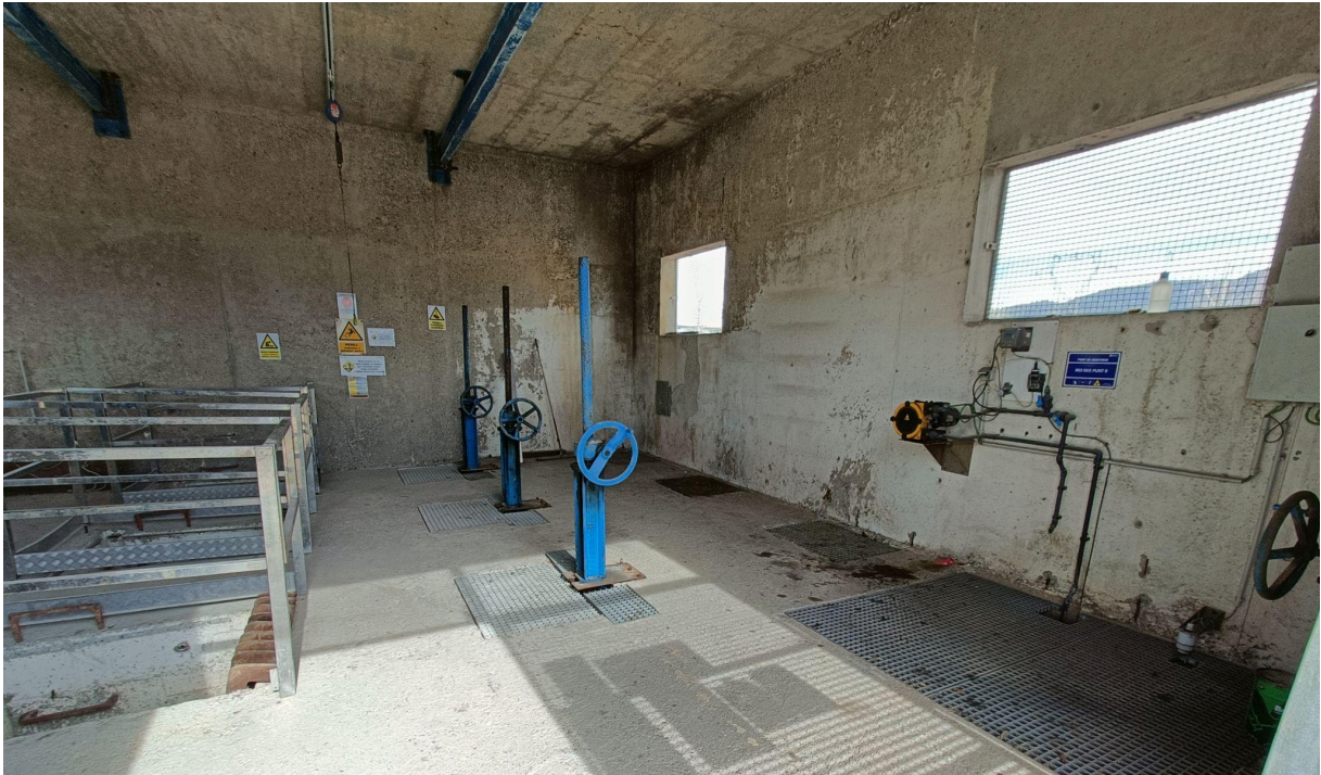
Vista general interior caseta per ubicació nou armari potencia i control
