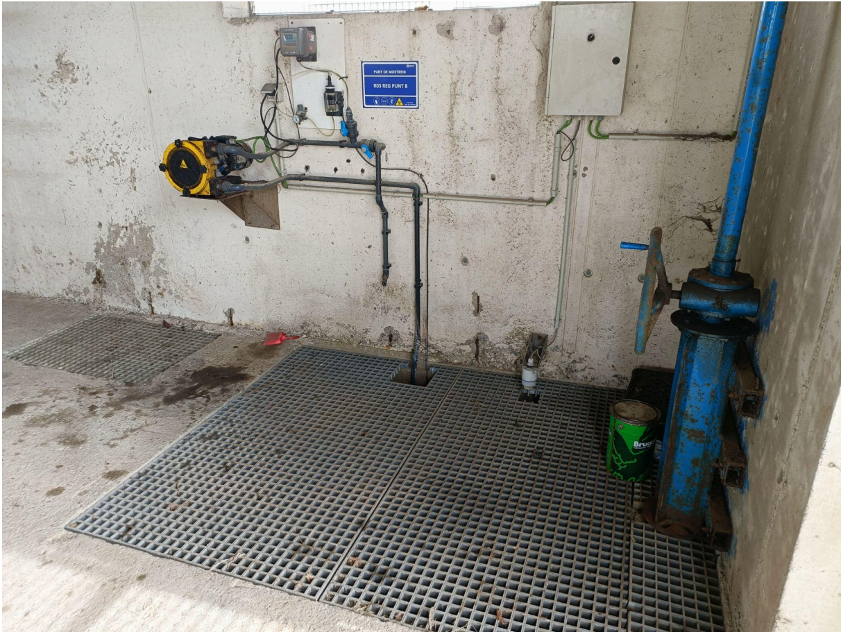
Vista general dels components del sistema de telecontrol actual
