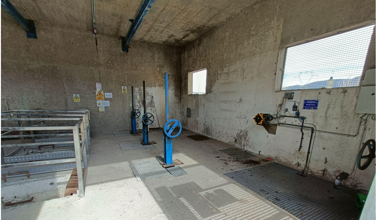
Vista general interior caseta per ubicació noves sondes de qualitat.
