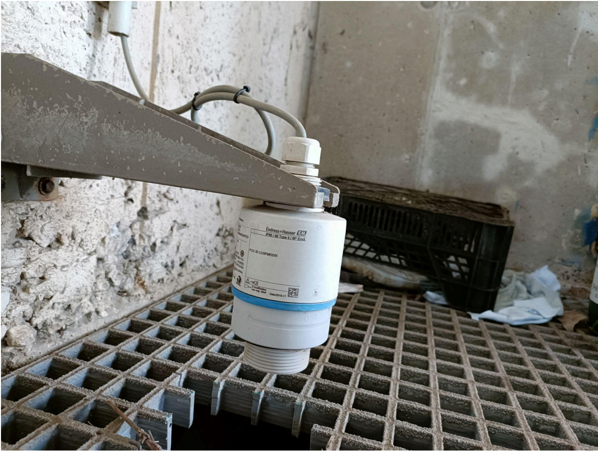
Detall del sensor de nivell actual
