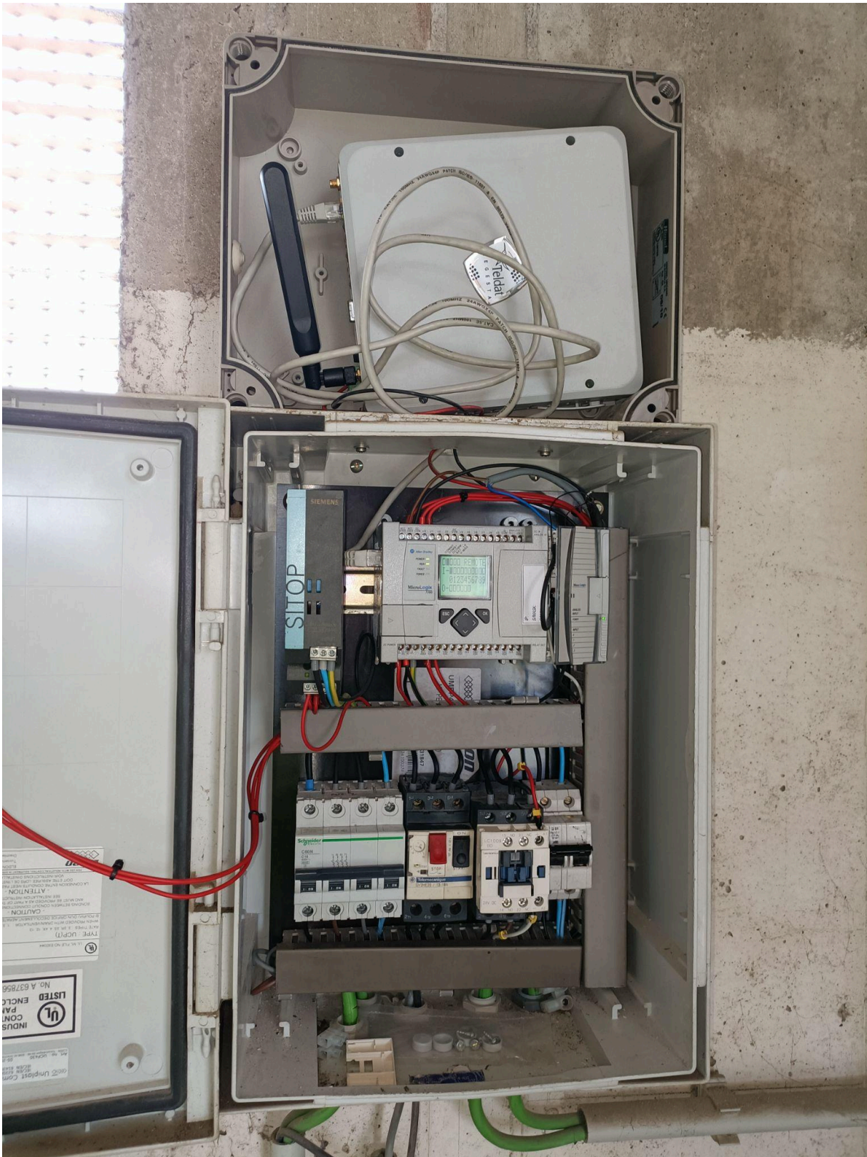
Detall de l'armari de potencia y control actual
