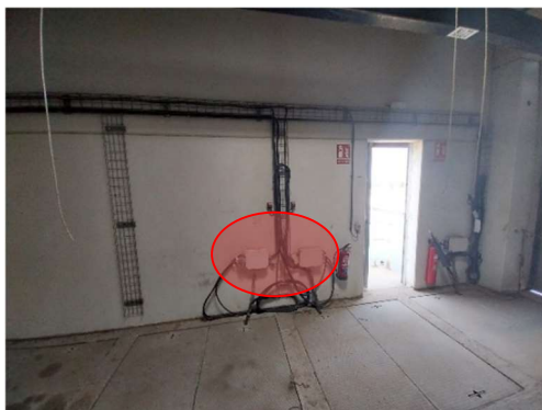
Ilustración 23. Cajas de empalme
