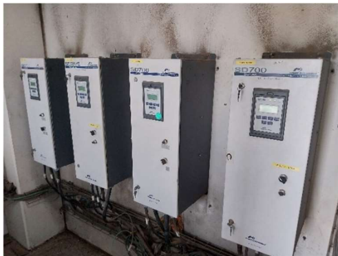
Ilustración 4. Variadores de frecuencia existentes
