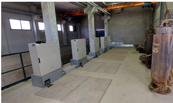
Figura 10. Vista de cuadros intermedios bombas y tapas actuales.
