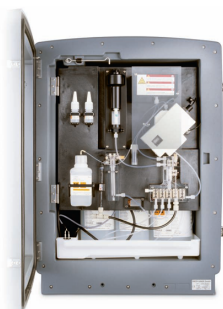
Figura 17. Detalle analizador de amonio.
