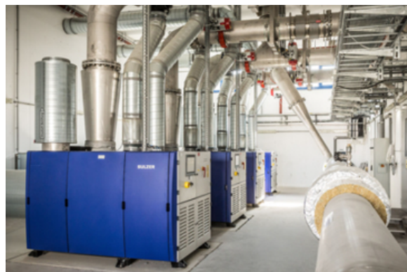
Figura 15. Detalle ejemplo de soplantes instaladas (II).
