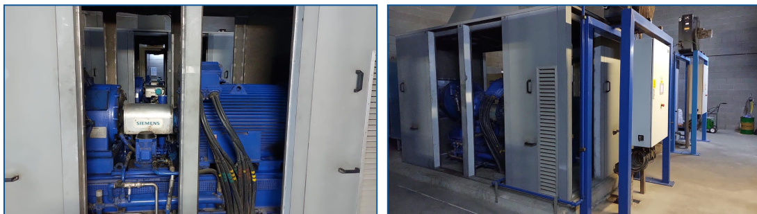
Figura 6. Soplantes de aire de los reactores biológicos de la EDAR de Sant Feliu de Llobregat a día de hoy.
