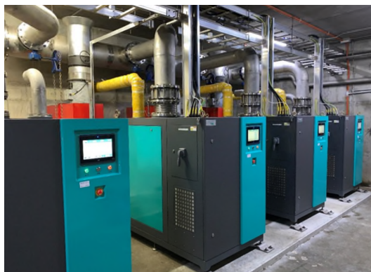
Figura 14. Detalle ejemplo de soplantes instaladas (I).
