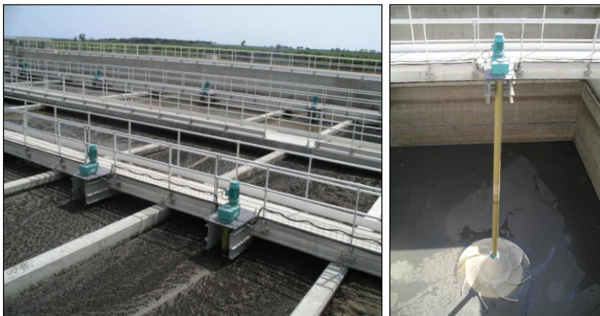
Figura 2. Reactores biológicos de la EDAR de El Prat de Llobregat
