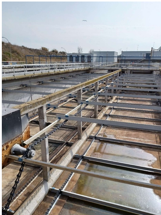
Decantador secundari buidat, vista dels conjunts de rasquetes
