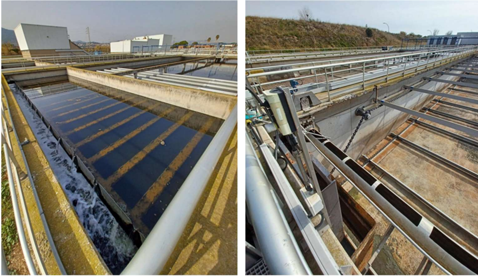
Canal transversal de recollida aigües decantades al final del decantador / .Skimmer recollidor de flotants al inici
