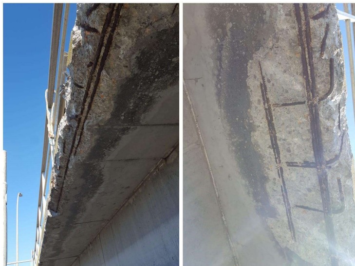
Voladissos amb greu degradació del formigó i les armadures
