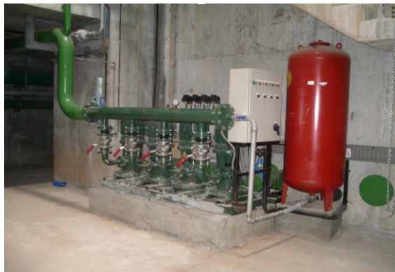
Bombas impulsión para distribución
