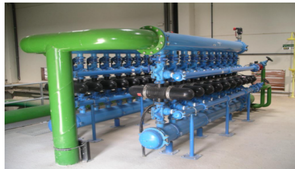
Sistema de filtración
