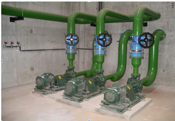
Bombas impulsión a sistema de filtración
