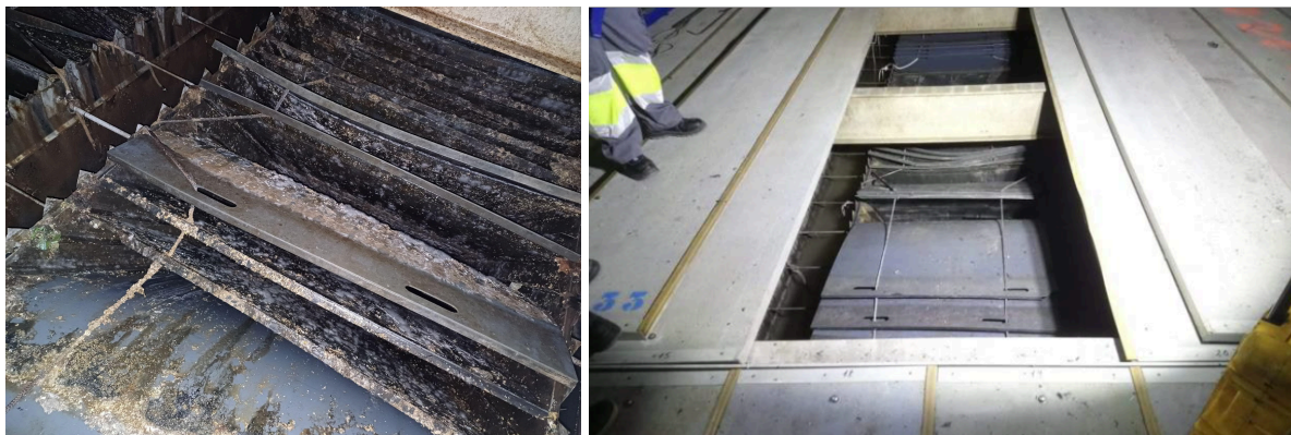
Imágenes del estado actual de las lamelas en algunas zonas de los decantadores primarios
