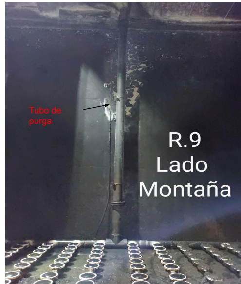
Foto 5: Tubo de purga en la cámara óxica.
