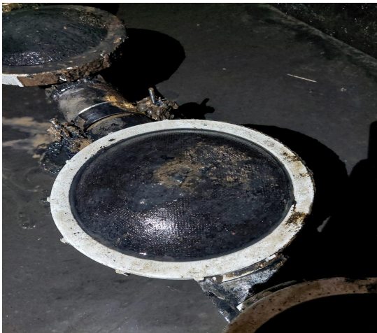
Foto 6: Estado actual de la membrana del difusor una vez limpia.
