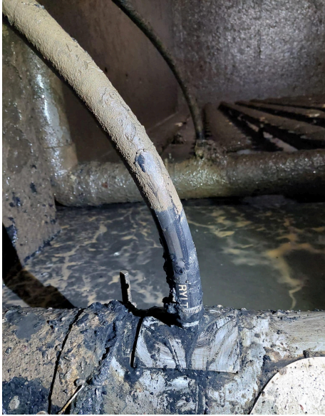
Foto 4: Conexión tubo de purga a la batería de difusores
