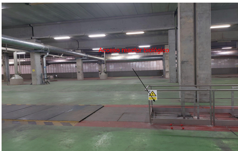
Foto 2: zona superficial Reactor Biológico
