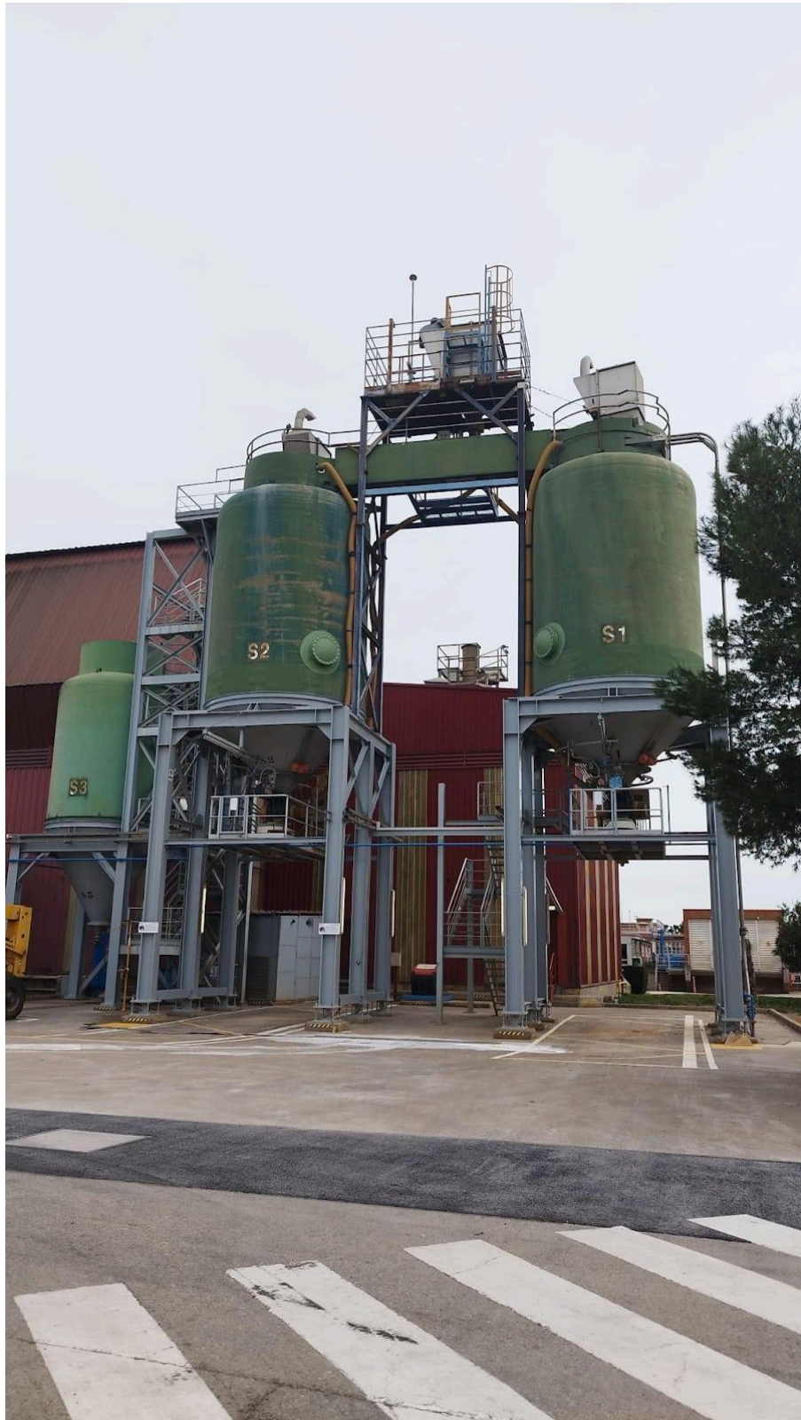
Instal·lació amb les dues sitges d'emmagatzematge de fang atomitzat
