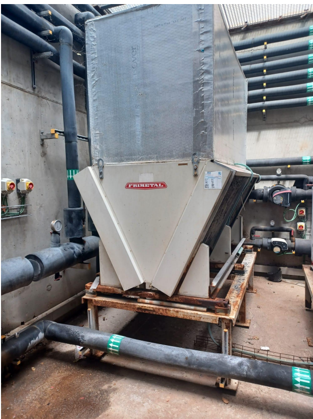
Condensadora a retirar, inclosa la instal·lació hidràulica i elèctrica
